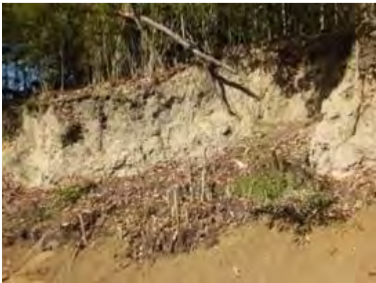
図3 濠水の浸食による空洞箇所（前方部南側面）
